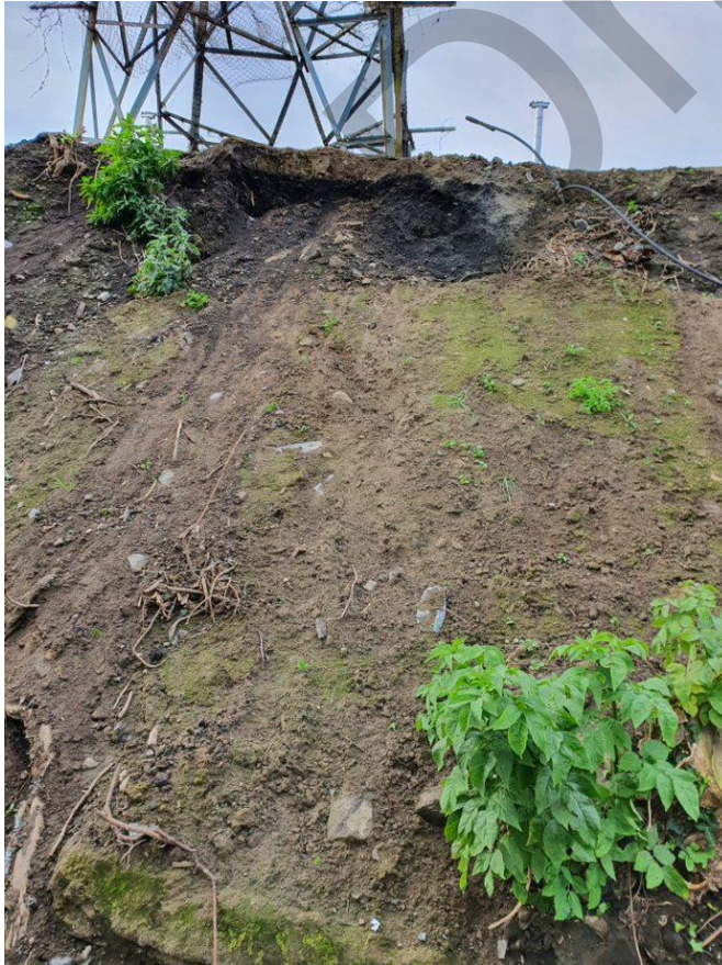
Photo 18: Soil Discolouration (Berm)
